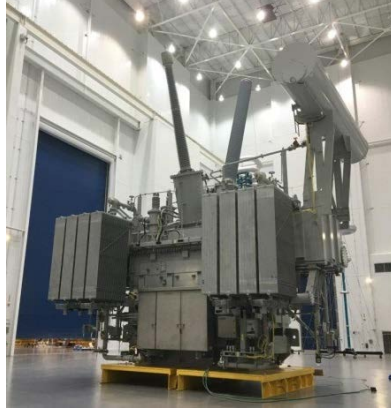
Yüksek kapasiteli 765kV transformatör
